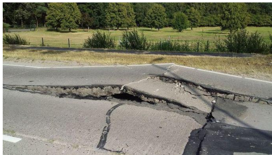
Schade aan een weg door hitte. Bron afbeelding: Hans Hanegraaff.
